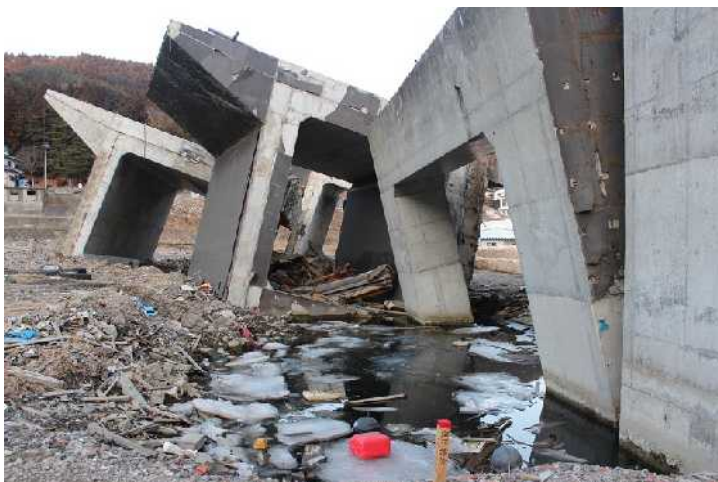
釜石市唐丹地区 なぎ倒されたままの防波堤
