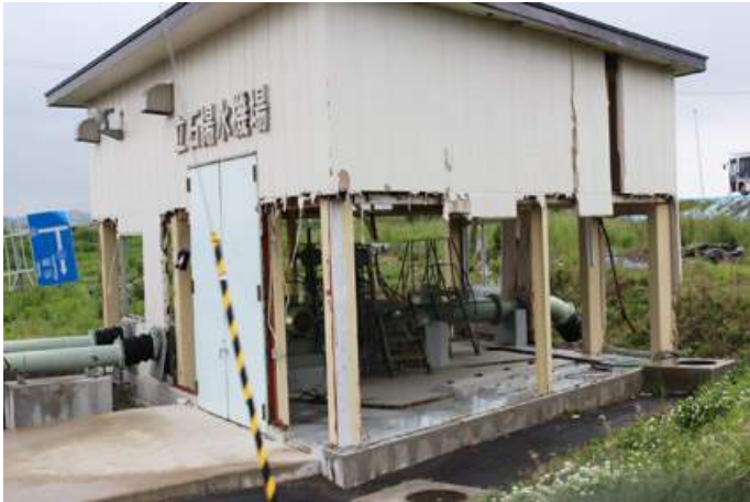
1年が経過しても修復も撤去もされない建物
